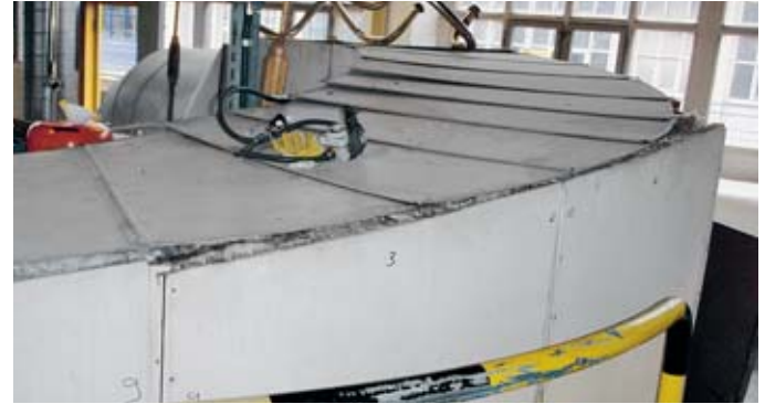
Asbesthaltige Dämmung hinter einer Verkleidung
