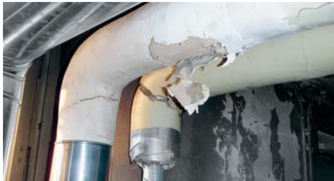
Rohrleitung mit asbesthaltigem Mörtel
