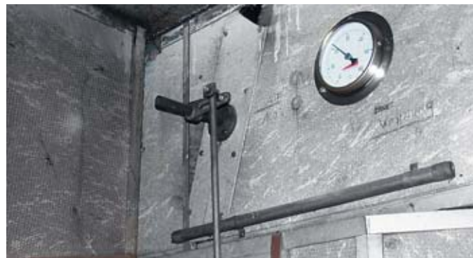
Lüftungskanal aus Asbestzementplatten
