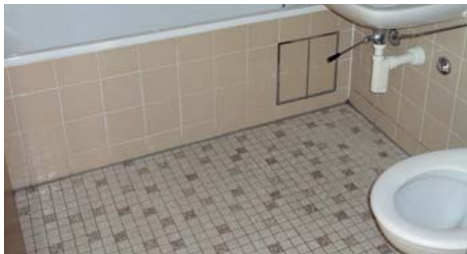
Platten an Boden und Wänden mit asbesthaltigem Kleber
