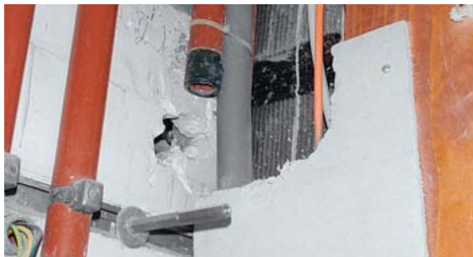
Brandschutzplatte in Steigzone
