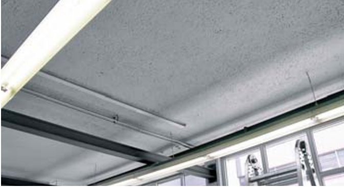
Spritzasbestbelag an Decke
