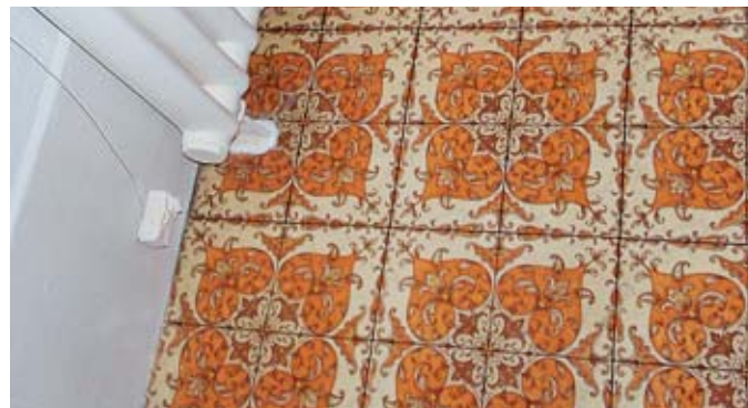
Typisches Muster eines mehrschichtigen asbesthaltigen Bodenbelags
