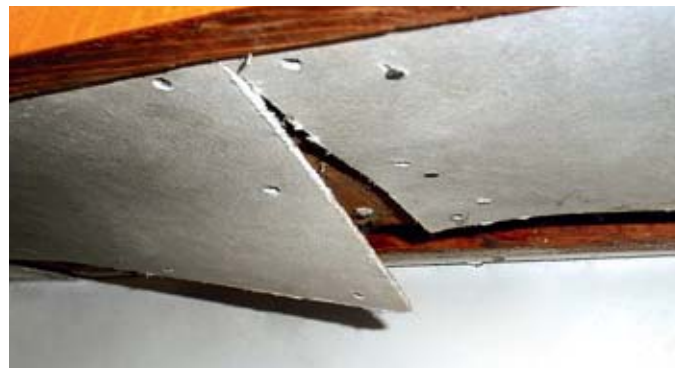
Asbesthaltige Leichtbauplatten als Brandschutz
