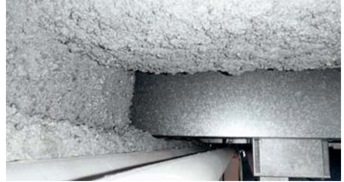
Spritzasbest als Brandschutz an Metallträger
